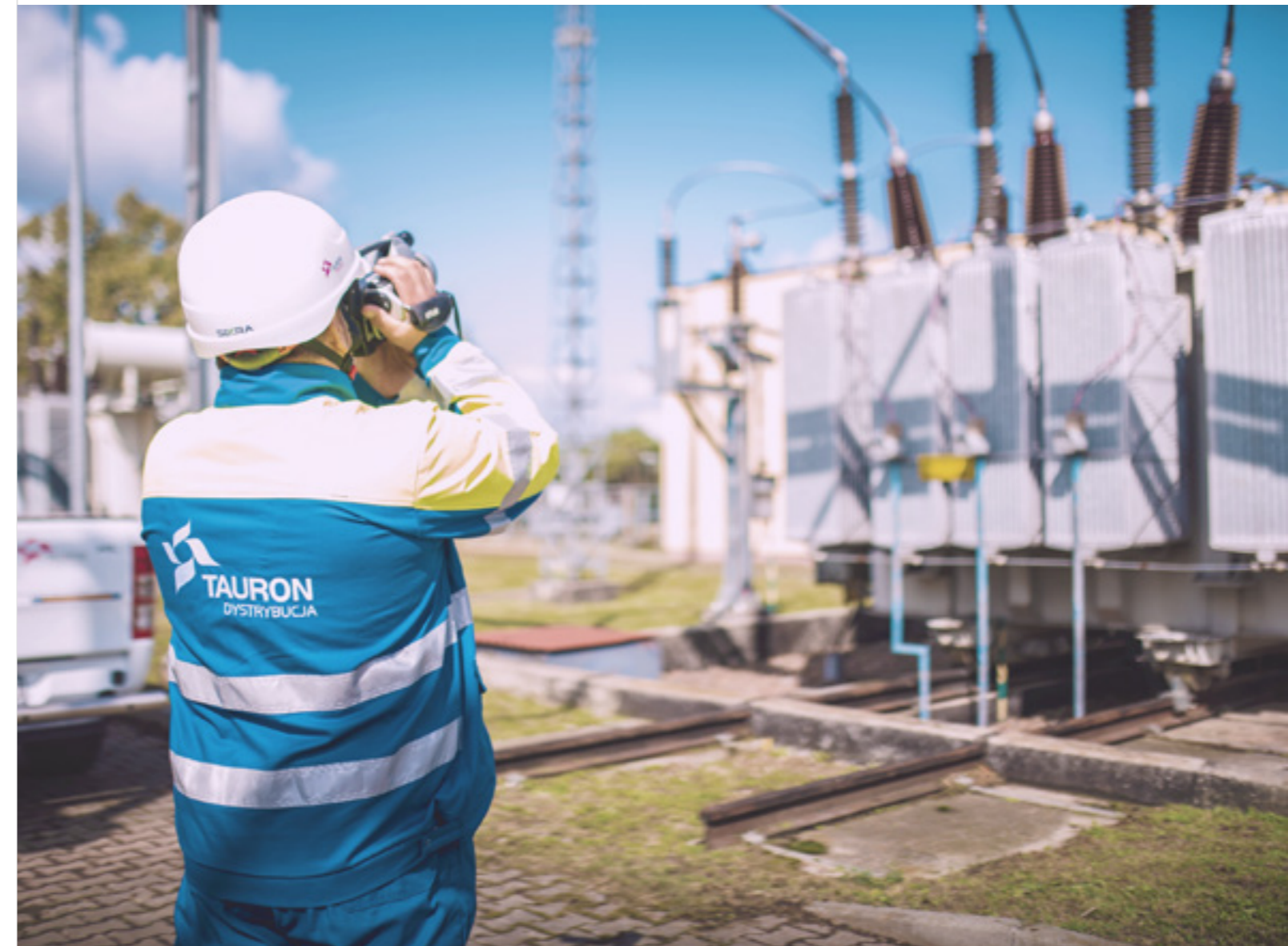
Tauron Dystrybucja, pomiary termowizyjne na stacji 110 kV
