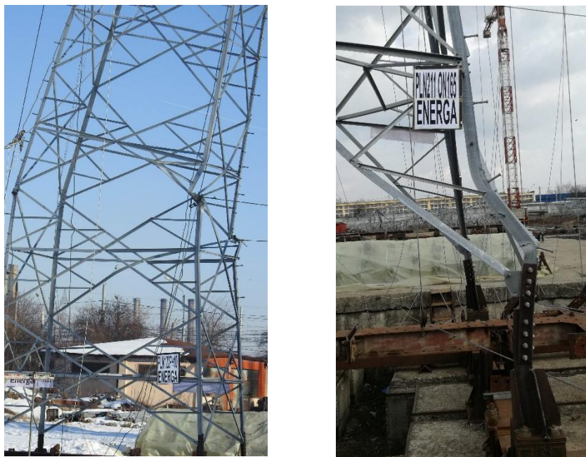
Rys. 4. Zniszczenie słupa PLN122 P (po lewej) oraz słupa PLN122 ON165 (po prawej).
